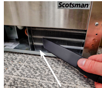
Superficie del condensador
